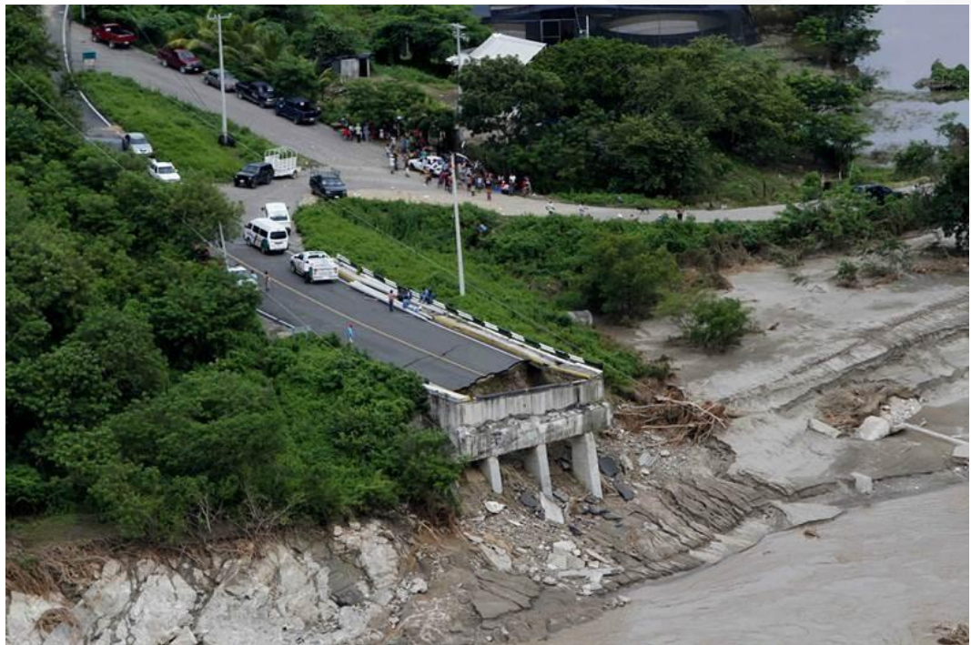
Daños causados por fenómeno perturbador
